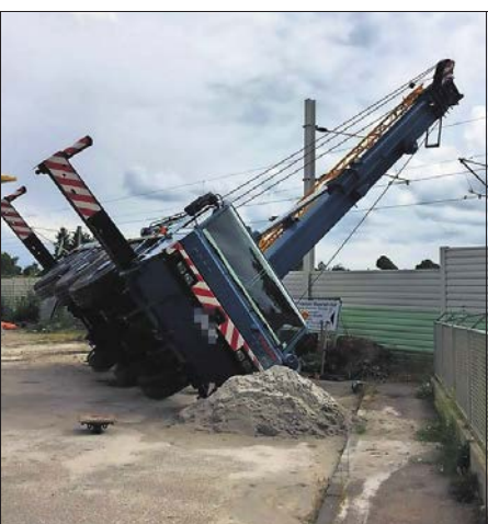
Der Baukran kippte am Bahnhof Magstadt auf die Seite und drohte auf Oberleitung und Gleise zu fallen Foto: SDMG
